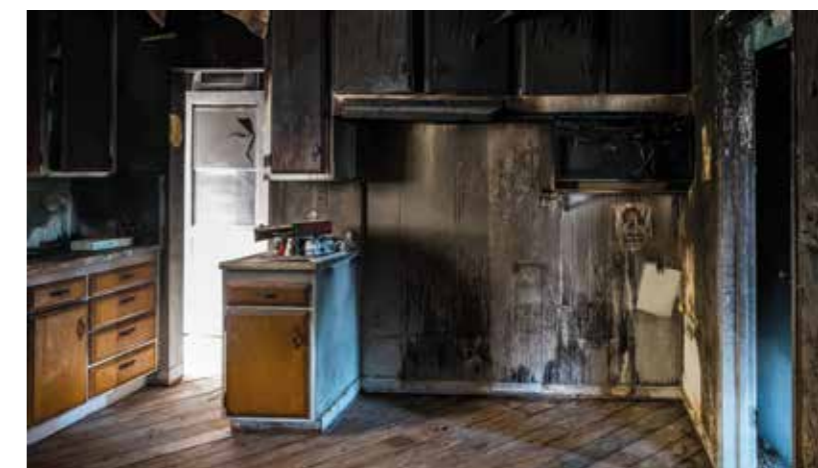
• 3D reality-opnames maken in twee uur een woonhuisschade compleet inzichtelijk
